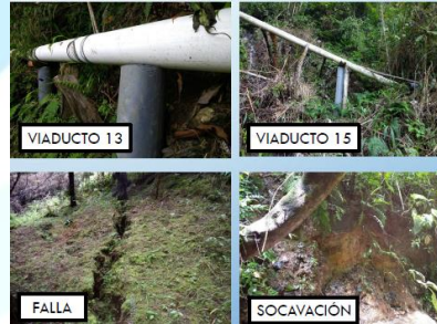
Estructuras del sistema en riesgo
