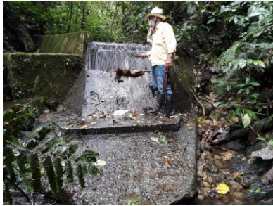
Bocatoma Sonadora ACUAROB(16)
